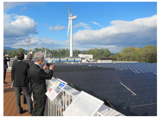
図4 FREAの定格出力500kWの太陽光発電設備
